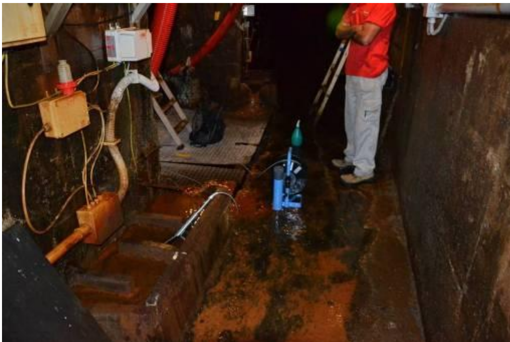
Fig. 12.11 – Misure effettuate nei drenaggi interni al cunicolo.
