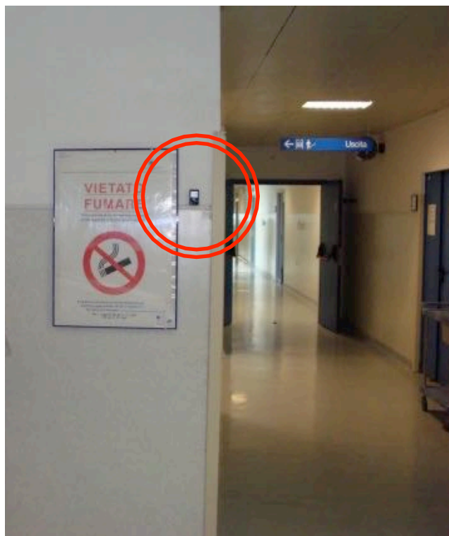
Figura 9 - Installazione dei sensori 174H all'interno del corridoio del reparto di Medicina Interna 1 dell'A.OB.
