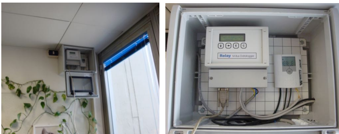
Figura 4 – Immagini del Data-logger e del misuratore di energia termica installati presso la segreteria di reparto
