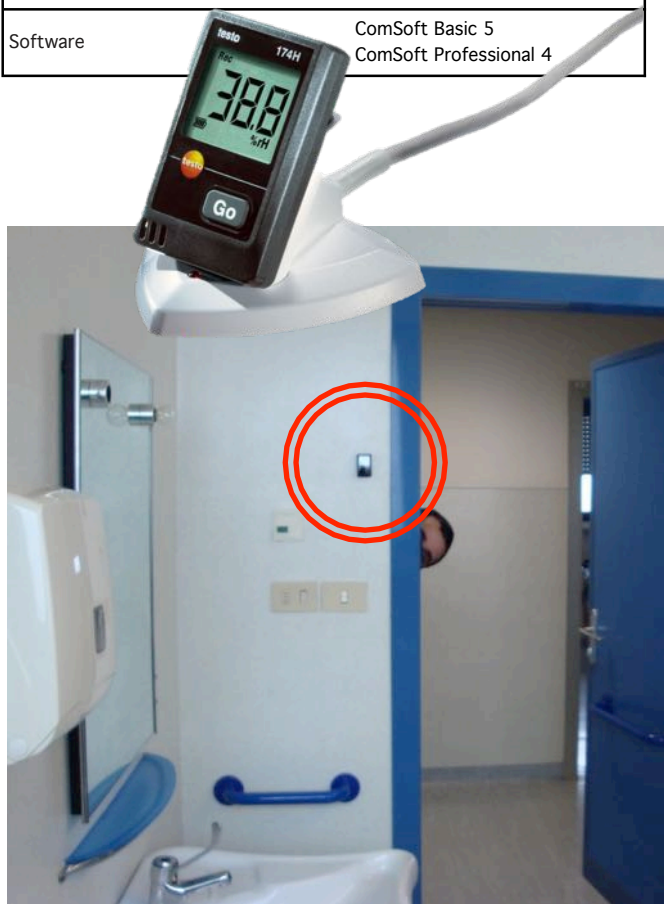
Figura 10 - Installazione dei sensori 174H all'interno del bagno disabili del reparto di Medicina Interna 1 dell'A.OB.
