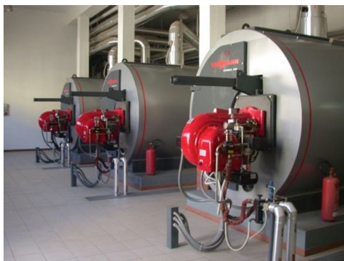
Figura 15 - Scorcio delle tre caldaie Viessman site nella Centrale termica
