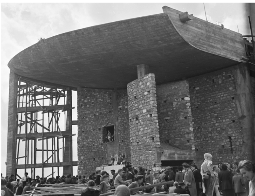
6: Le murature in pietra di recupero con le buche pontaiie a vista.
