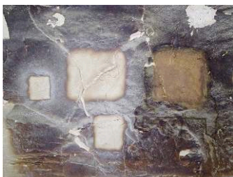
Fig. 11-12. TT 33. Résultats obtenus par microgommage (projection de particules fines) avec de l'oxyde d'alumine à 220 mesh/pression \leq 2 bars, sur une surface de cassure dans la salle II avec différents réglages. Comparaison avec un test chimique réalisé à droite (S. Duberson).
