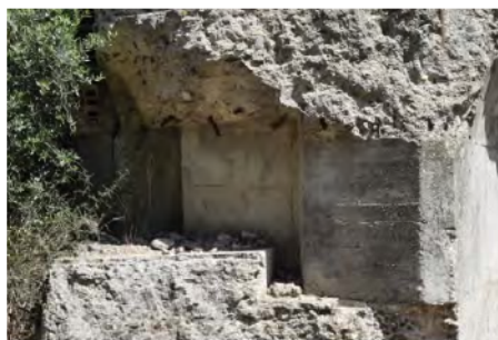
Fig. 3– Fortino parzialmente demolito. Si possono apprezzare le caratteristiche materiche. Strada 25 Ovest. Foto A. Martinez – Medina.
