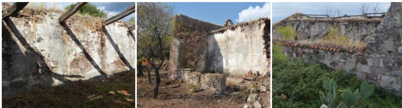
Chiesa di S. Giovanni. Grado di ruderizzazione delle strutture
