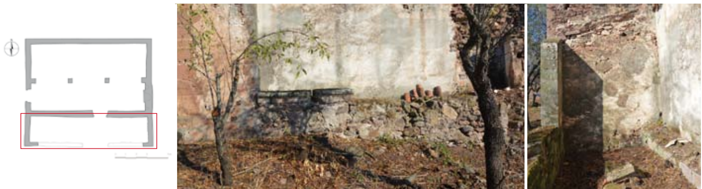
Chiesa di S. Giovanni. Loggia attualmente allo stato di rudere.
