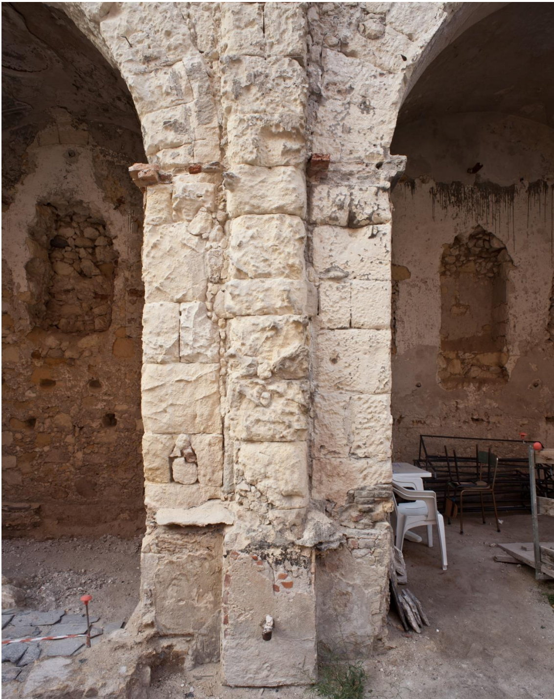
Fig. 10. Parte residua della facciata della chiesa sulla via Barcellona; si riconosce sulla destra la cornice di coronamento dal tipico andamento a doppia inflessione, diffuso nelle chiese della città durante il XVII secolo (foto Stefano Ferrando).
