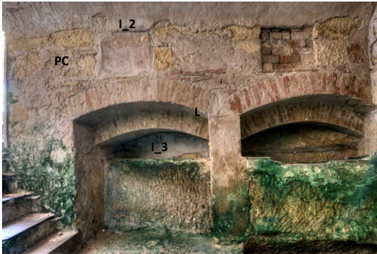
Figura 2.9 parete C: visibili gli arcosoli di rifacimento in laterizi, la nuova muratura in blocchi di Pietra Cantone e laterizi e l'intonaco di restauro, pesantemente disgregato.
