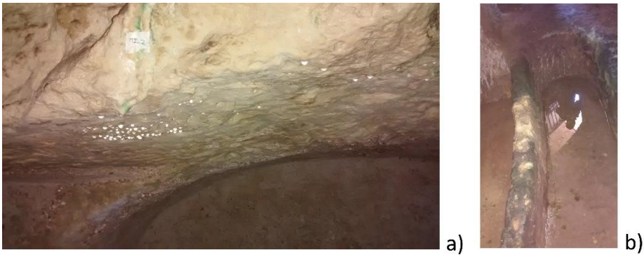
Figura 2.35 a) Particolare dell'umidità della parete B. b) Particolare dell'accumulo di acqua nel loculo del pavimento adiacente alla parete B.
