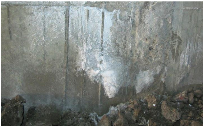
Figura 1.3 Fenomeni di cristallizzazione salina nelle pareti in calcestruzzo armato addossate al sito archeologico di Viale Trieste 105, Cagliari. Visibili le efflorescenze saline di mirabilite e i fenomeni di distacco conseguenti all'azione espandente di questo sale [13].
