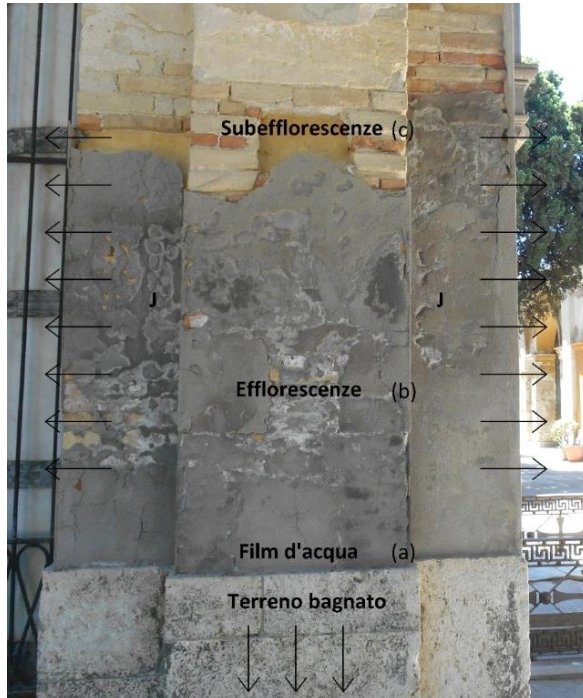
Figura 1.11 Formazione di efflorescenze a subefflorescenze sui muri. Cimitero Monumentale di Bonaria a Cagliari, zona a: muratura bagnata, flusso evaporativo inferiore al flusso di rifornimento della soluzione; zona b: flusso evaporativo uguale al flusso di rifornimento della soluzione, formazione di efflorescenze; zona c: flusso evaporativo maggiore del flusso di rifornimento della soluzione, arretramento del fronte di evaporazione e cristallizzazione del sale sotto forma di subefflorescenze.
