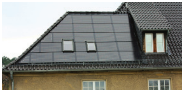
Fig. 1: Impianto fotovoltaico integrato nella copertura di un edificio del 1910 a Quedlinburg.
