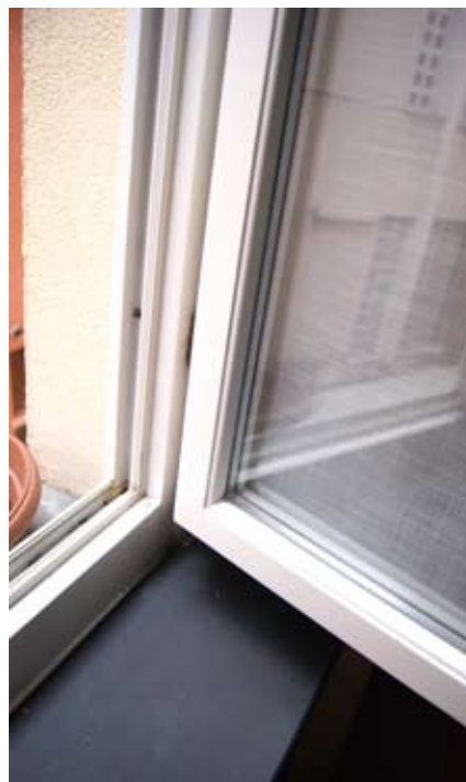
Fig. 32. Sopra, infisso in Via Santa Fede 6. Fig. 33. A destra, infisso dissonante.
