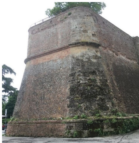
Fig. 3- Fortezza medicea (Siena), settore del paramento murario del Bastione di San Domenico, realizzato in laterizio e conci di arenaria pliocenica
