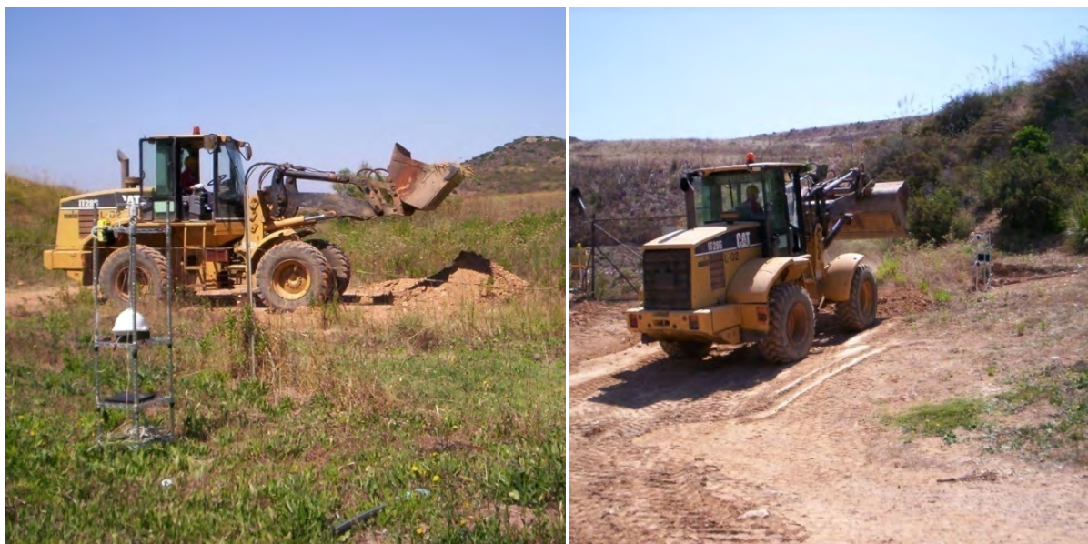
Figura 4.15: Strumenti nella zona di carico e nel piazzale durante l'attività 3
