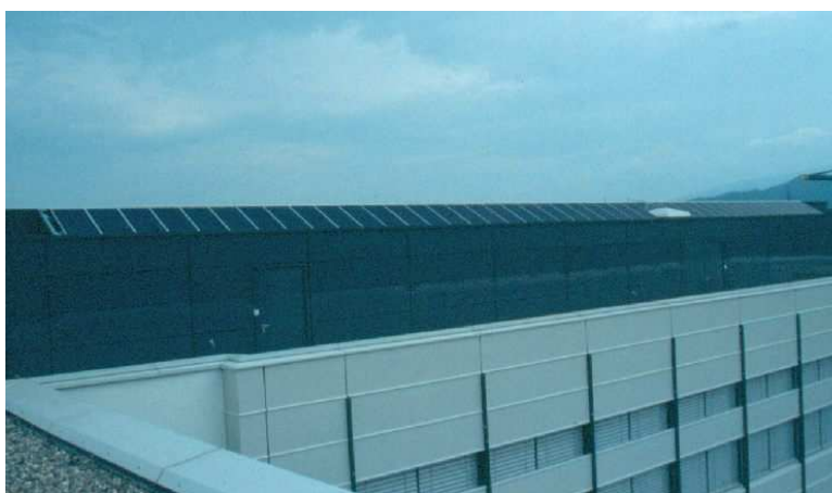
Vista della copertura PV sull'ala centrale
