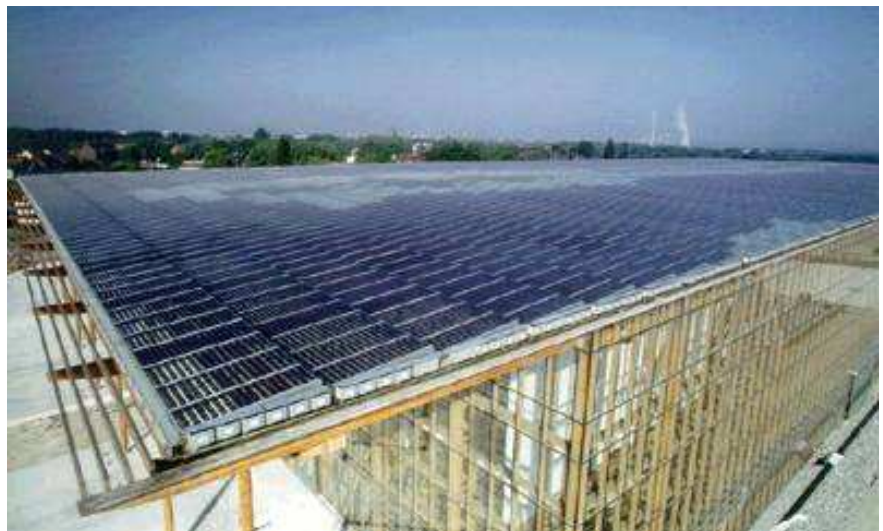
Vista della copertura FV
