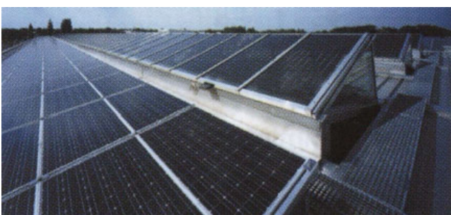
Vista dall'esterno dei pannelli in copertura
