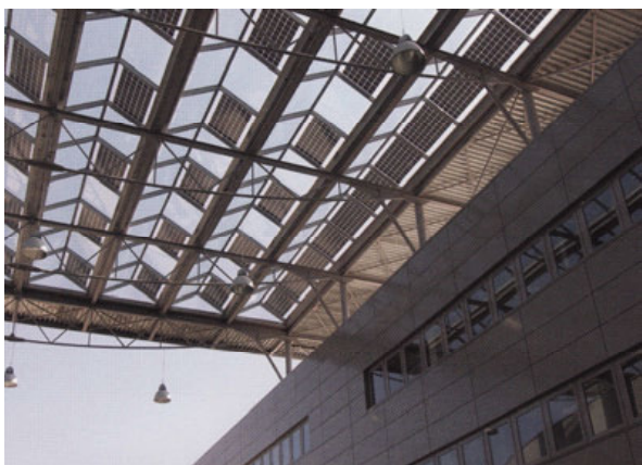
Particolari della copertura fotovoltaica
