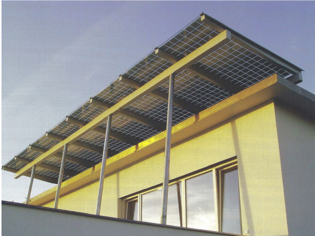
Pensilina fotovoltaica su edificio residenziale a Pettenbach, Austria
