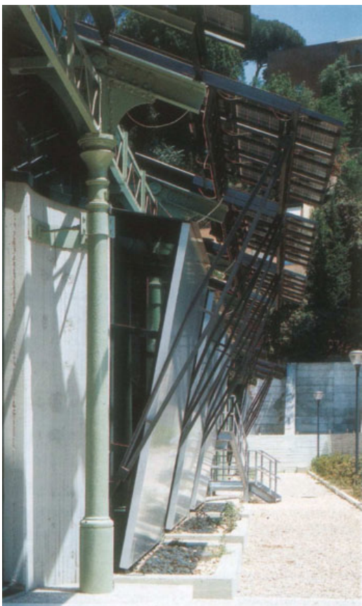
Sistema delle pensiline fotovoltaiche
