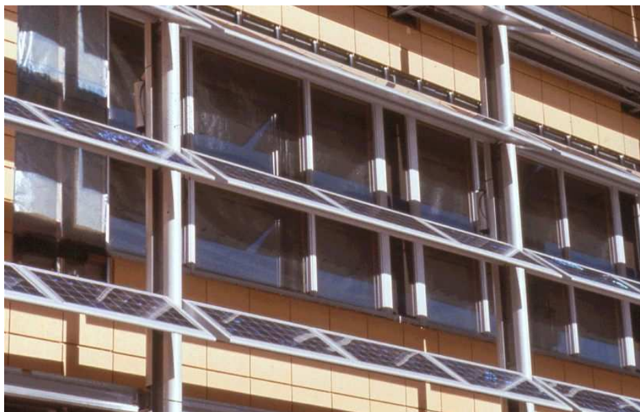
Particolare della schermatura fotovoltaica
