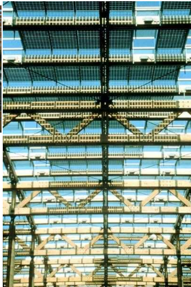
Vista dall'interno della copertura PV
