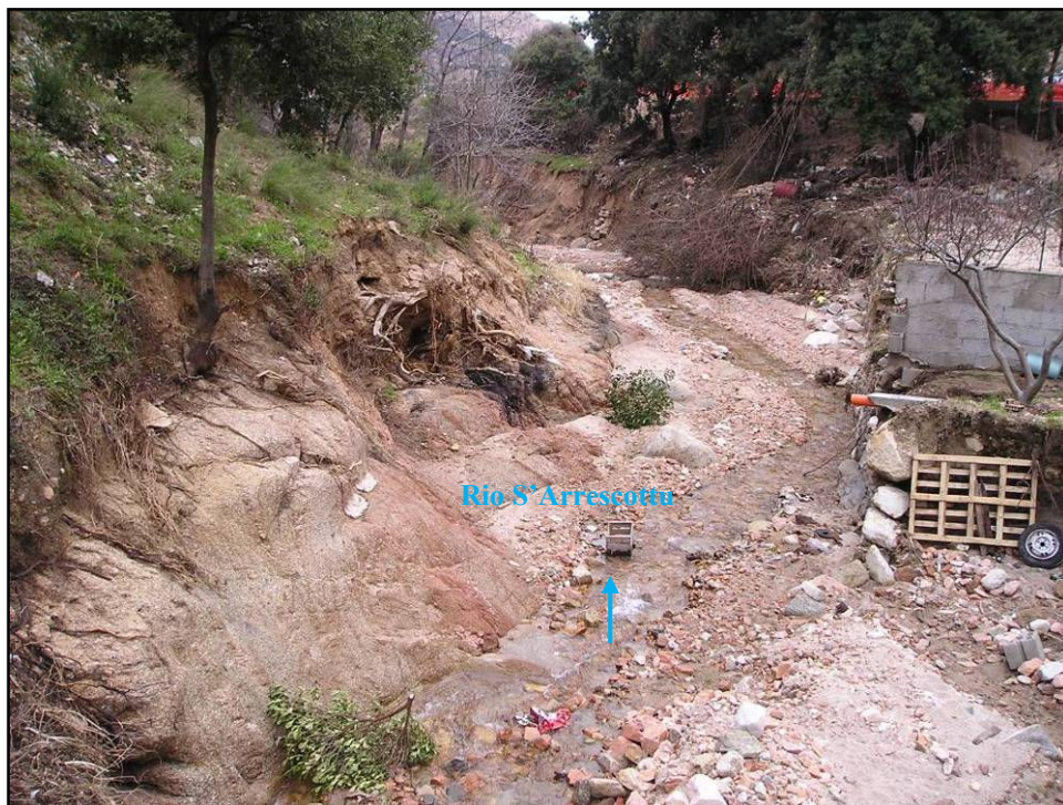
Figura 40 – Vista dei fenomeni erosivi del rio S'Arrescottu a valle di via Roma
