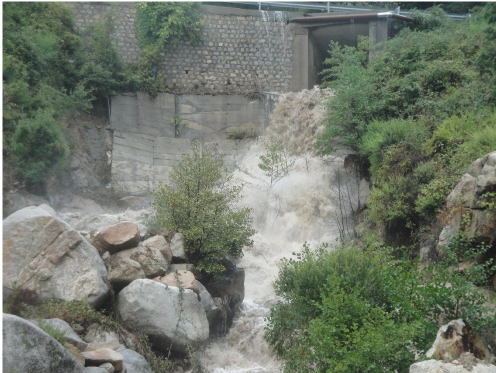
Figura 114 – Salto a valle del ponte sulla circonvallazione in occasione delle piogge del 12 ottobre 2010
