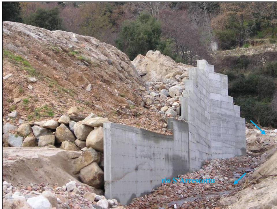
Figura 37 – Vista dei fenomeni di instabilità di sponda ed erosivi lungo il rio S'Arrescottu in sponda destra in località Gurthoi
