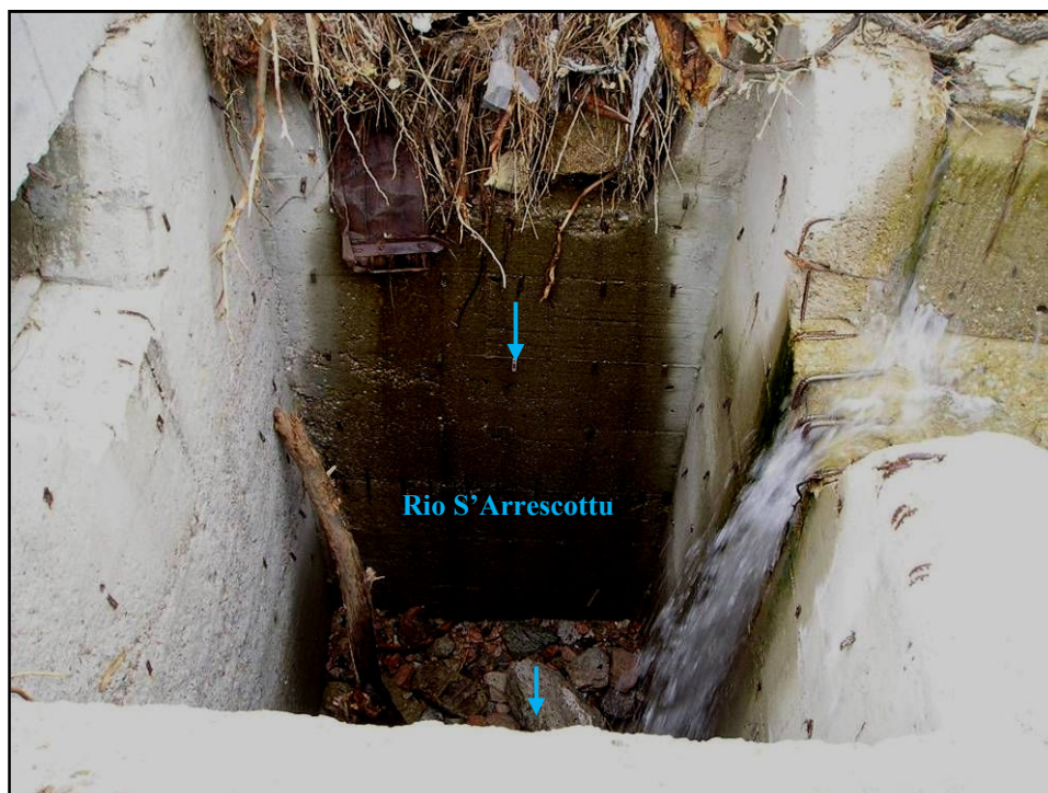
Figura 105 – Vista del secondo attraversamento della S.P. 27 (circonvallazione), ostruito nel corso dell'evento alluvionale
