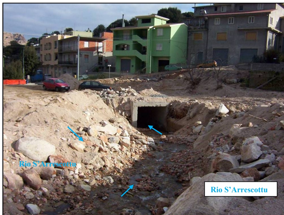
Figura 38 – Vista dei fenomeni di dinamica torrentizia del rio S'Arrescottu con ostruzione della tombinatura di via Roma
