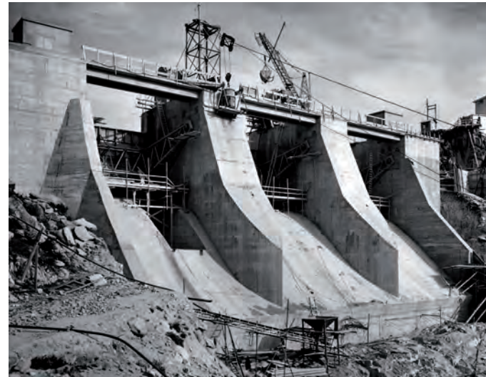
a destra Benzone - ottobre 1962 - la traversa in fase di ultimazione; vista sul coronamento. (P.TMM, A.OMOD)
