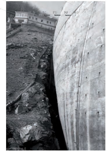
Diga di Osiglietta, Liguria; tipologia a cupola, alta 70.70m, terminata nel 1939 (PROG.D)
