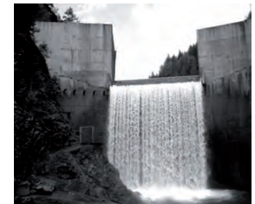
dall'alto: Diga di Monte Crispu, Bosa (Sardegna); terminata nel 1961 è una diga ad arco-gravità utilizzata per la sola laminazione delle piene; la diga non è invasabile in quanto mai collaudata. Diga di Pontisei, Veneto; terminata nel 1956 è una diga a cupola il cui invaso è stato ridotto a seguito di alcuni eventi franosi all'interno dell'invaso; Diga di Digonera, Veneto; è una diga a cupola la cui costruzione fu interrotta a seguito del distro del Vajont. (WIKI, PROG.D.)
