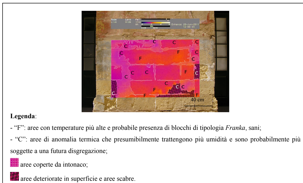
Figura 3.35: Termogramma della superficie del pilastro.
