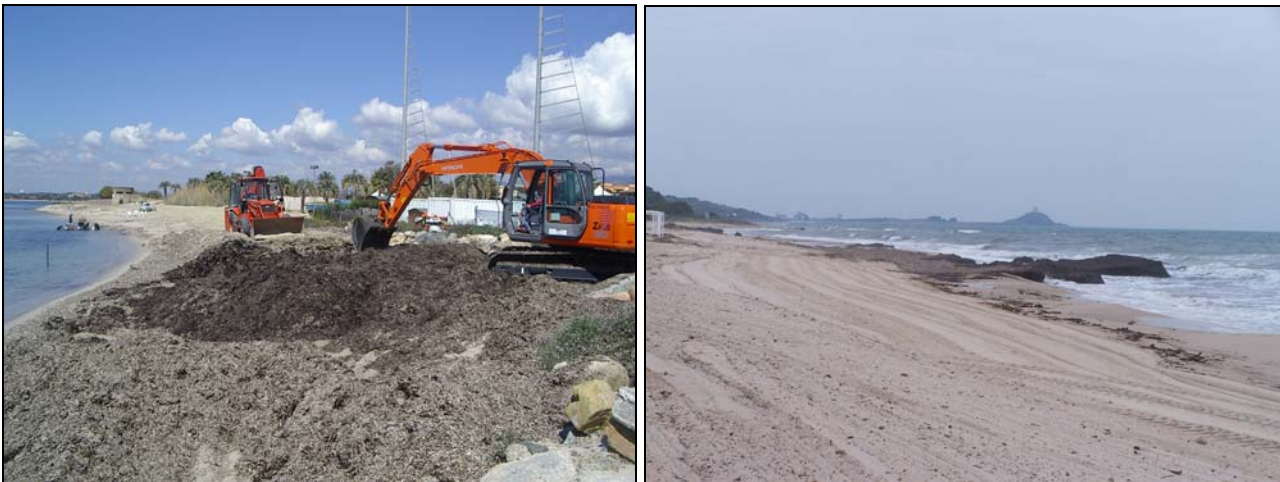
Fig. 87 – Esempi di rimozione della banquette con mezzi meccanici pesanti nel litorale di Quartu S.E. e veduta della spiaggia di Santa Margherita di Pula dopo la “pulizia” della spiaggia. Le strutture di spiaggia sono state spianate o modificate antropicamente con l’innescare di processi di mescolamento sedimentario, solchi erosivi, asporto di ingenti quantità di sabbia, compattazioni e modificazioni delle caratteristiche naturali fisico-meccaniche del corpo di spiaggia (De Muro e Dore, 2008).
