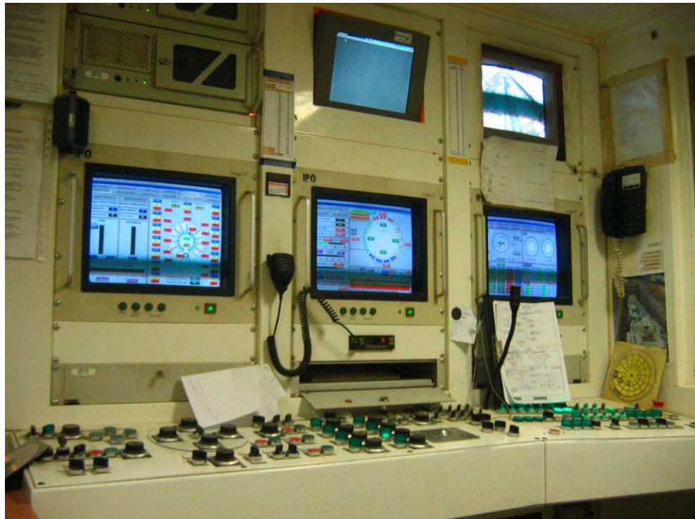
Figura 57: Cabina comandi operatore
