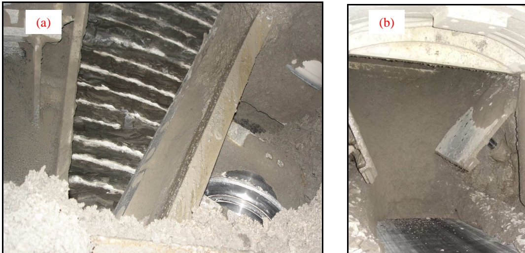
Foto 72: (a) - Particolare del fronte di scavo e del materiale che passa tra le aperture della testa; (b) - Materiale estratto dalla camera di scavo con il nastro primario
