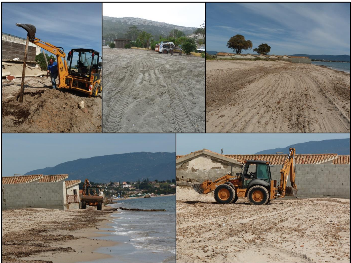
Figura 54. Serie di immagini che documentano le attività di manutenzione che vengono eseguite dopo le mareggiate su tutta la spiaggia.
