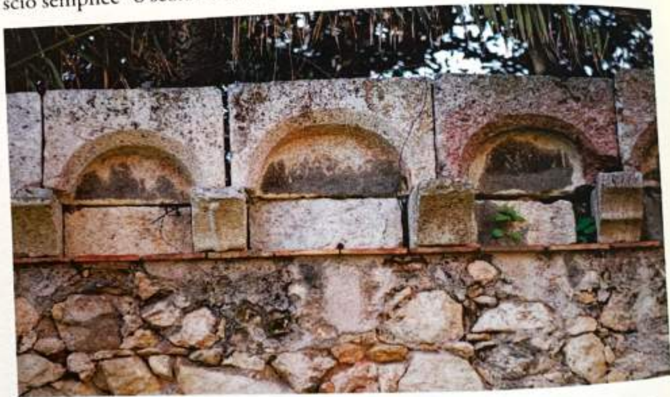
Fig. 7. Cagliari, Villa Vivaldi Pasqua, archetti pensili e peducci, dettaglio (Fonte: foto autore).
