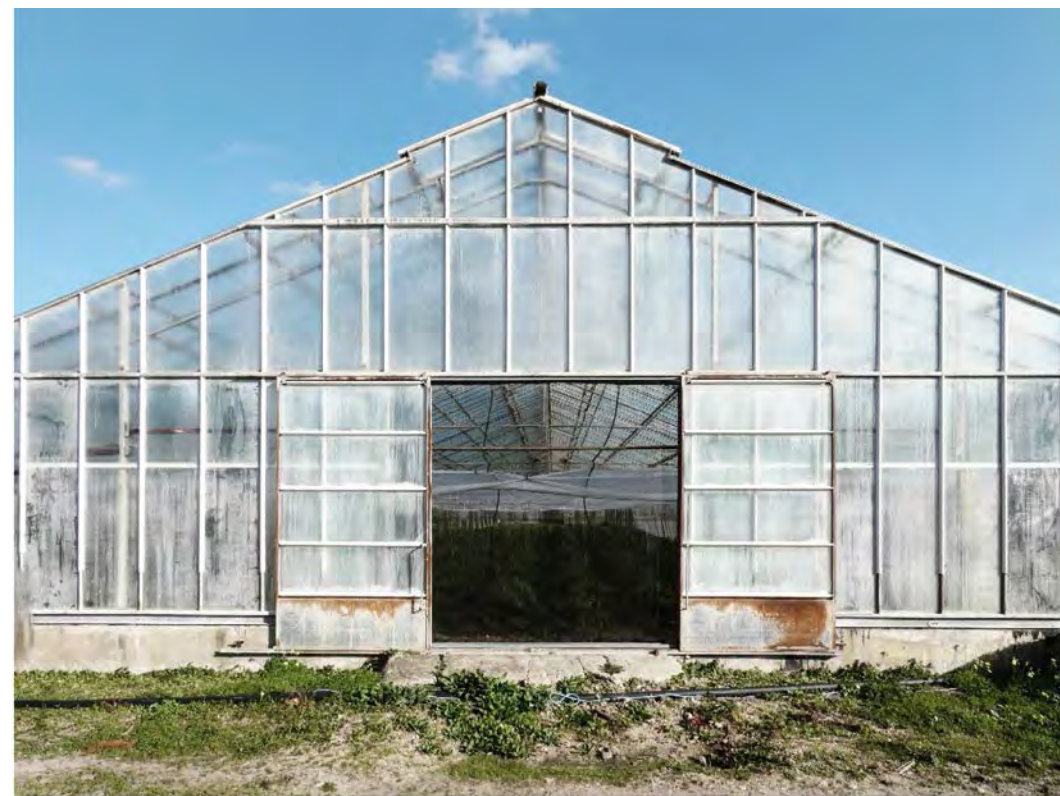
[ Figura 3.79 ] La tettonica: Oristano (Campidano): ser- ra meccanizzata in vetro e acciaio per l'orticoltura in- tensiva;
